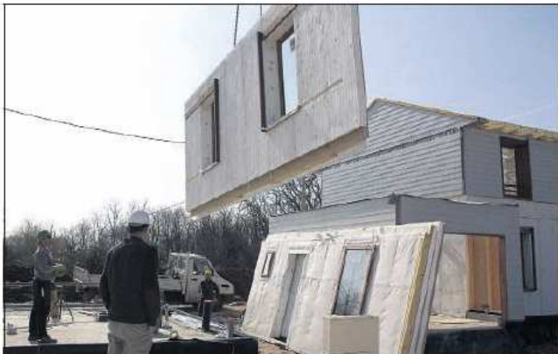
LA CHARITÉ-SUR-LOIRE (NIÈVRE), VENDREDI. Ce pavillon, à ossature en bois, est destiné au logement social en location. Une première en France. (LP/XAVIER GAUTHIER.)
